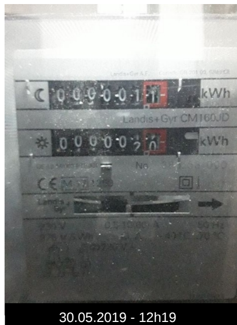
Photo 2 (Compteurs / Electricité (HC))
