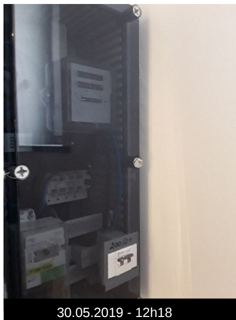
Photo 1 (Compteurs / Electricité (HP))
